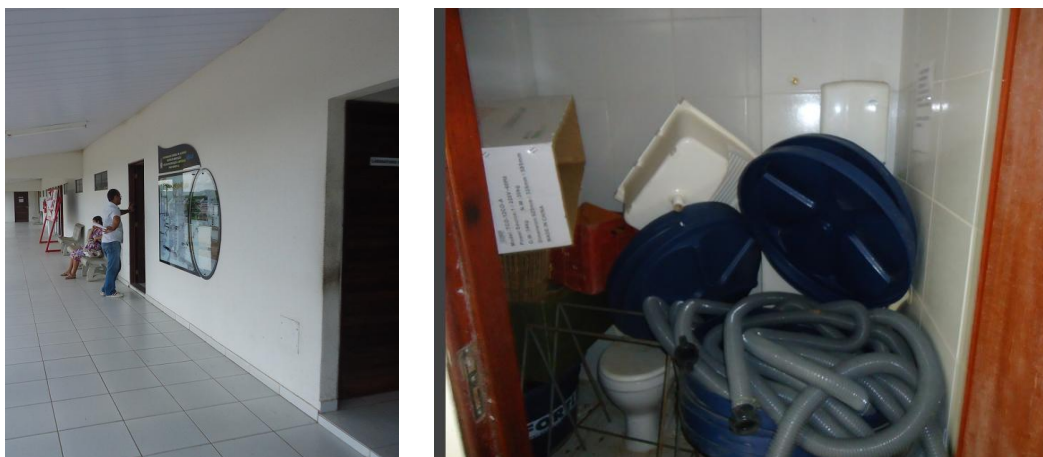
Figura 60.3 - Corredor Acesso ao Setor Administrativo – desnível no acesso das salas. Figura 60.6 - Banheiro para pessoas com deficiência sendo usado como depósito.
