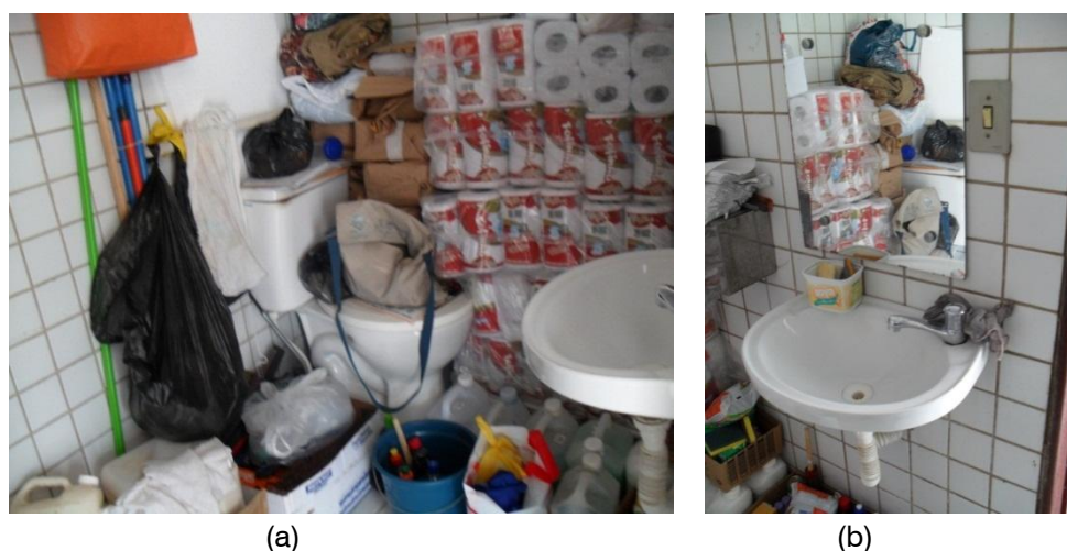
Figura 60.6 – Detalhe - Banheiro acessível é utilizado como depósito de material de limpeza, portanto não atende a sua função principal.
