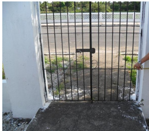
Figura 60.8 – Acesso de pedestres a Av. Beira Rio – piso antiderrapante adequado, largura do portão adequada, falta comunicação visual e tátil, e corrimãos na rampa de circulação.
