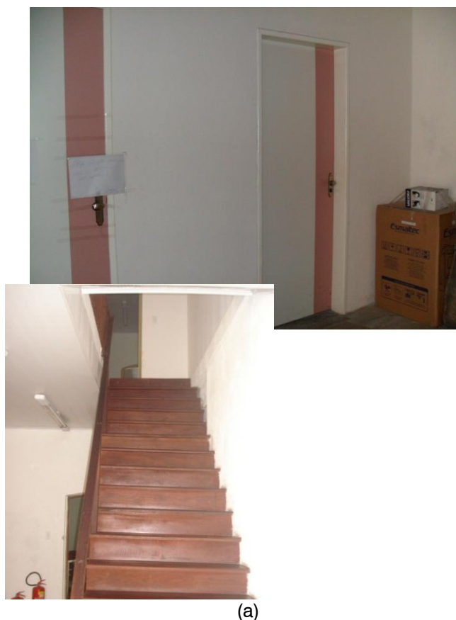
Figura 63.6 – Detalhes – (a) Vista dos banheiros no pavimento térreo – acessíveis. (b) Vista da escada de acesso ao pavimento superior.
