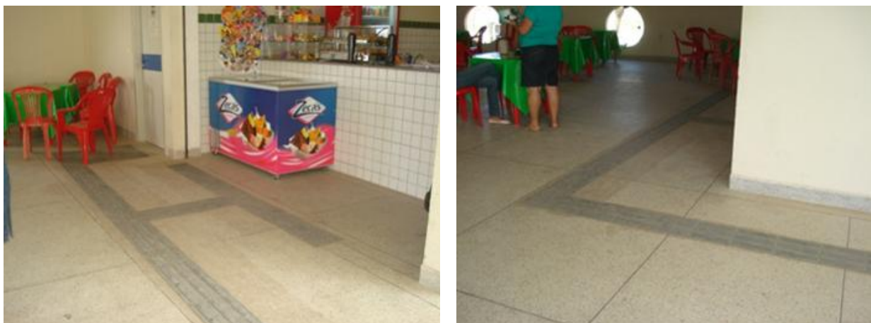
Figura 44.15 e 44.16 - Piso tátil direcional e de alerta em material plástico, colado no piso definitivo. O desgaste do material plástico pode causar acidentes.
