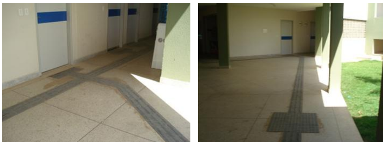
Figura 44.17 e 44.18 - Piso tátil direcional e de alerta em material plástico, colado no piso definitivo. O desgaste do material plástico pode causar acidentes.
